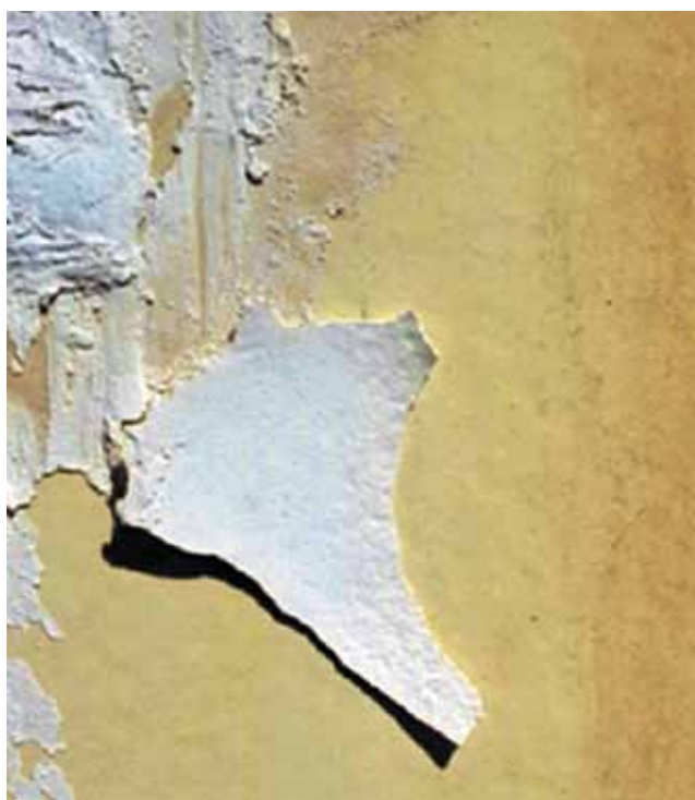
▲ Рис. 6. Отслоение излишне разбавленной краски ▲ Fig. 6. Peeling off excessively diluted paint
